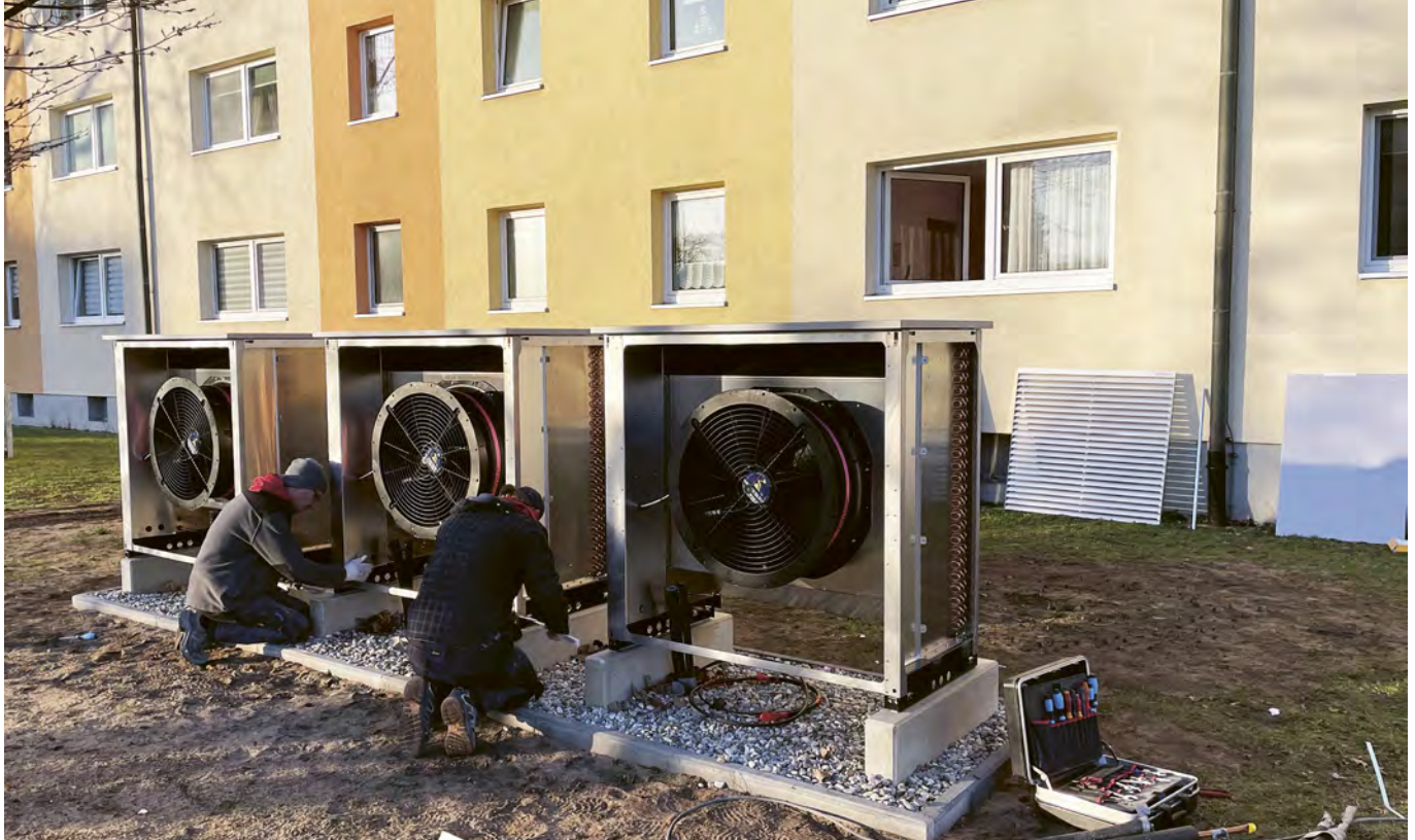
Installation von drei neuen Luftwärmepumpen am Bestandsgebäude Mauerstraße 26, 28, 30 in Fürth. Sie sorgen für eine klimafreundliche Wärmeversorgung und sparen Energiekosten.
