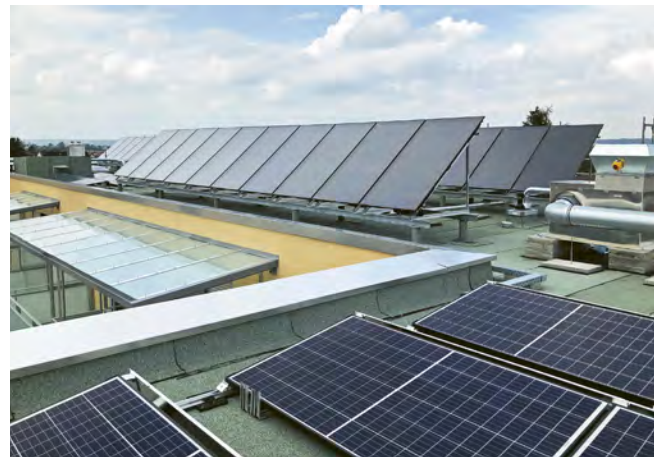
Solarthermie- und Photovoltaikanlagen auf den Dächern der Astenstraße in Oberasbach.
